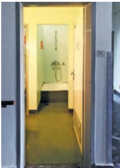
Slika 8. Sanitarni čvor na trećem spratu objekta O-I (Stacionara I). Iako na vratima stoji znak pristupnosti, čvor je tijesan i bez odgovarajuće opreme.
